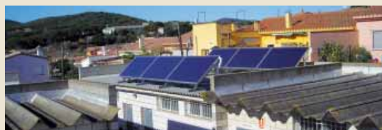
Instal·lació d'energia solar tèrmica al camp del Gregal
