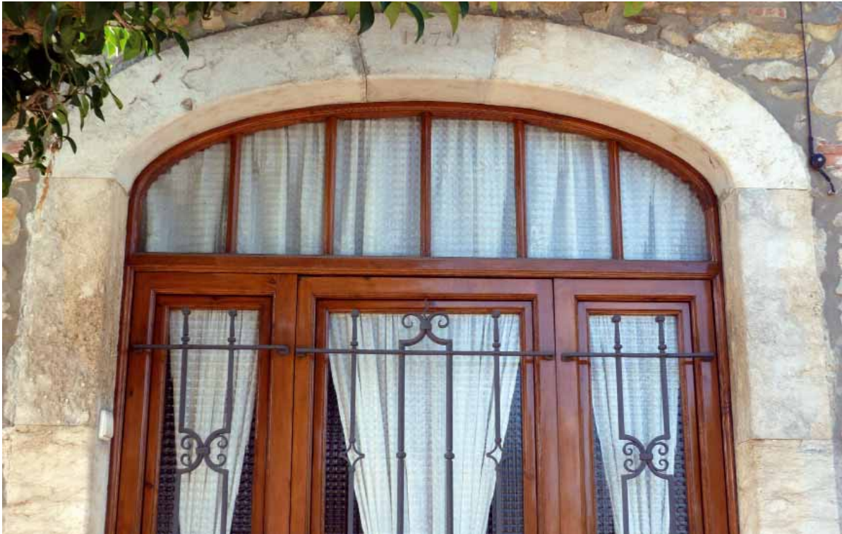
El ritual de protegir les cases llançant sal beneïda a les portes de les cases va donar lloc amb els anys a un desgast de la pedra, com es pot veure al brancal esquerre de cal Fray. A la llinda podem veure la data en què fou construïda la casa, 1879.
