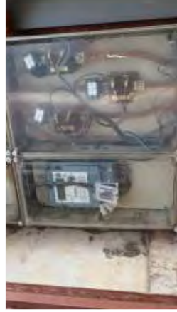
Punt de connexió a escomesa elèctrica
