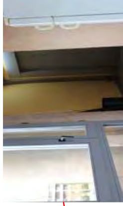
Espai entre plantes per fer passar la línia trifàsica AC
