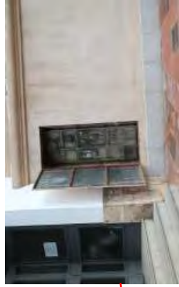
Punt de connexió de la instal·lació fotovoltaica
